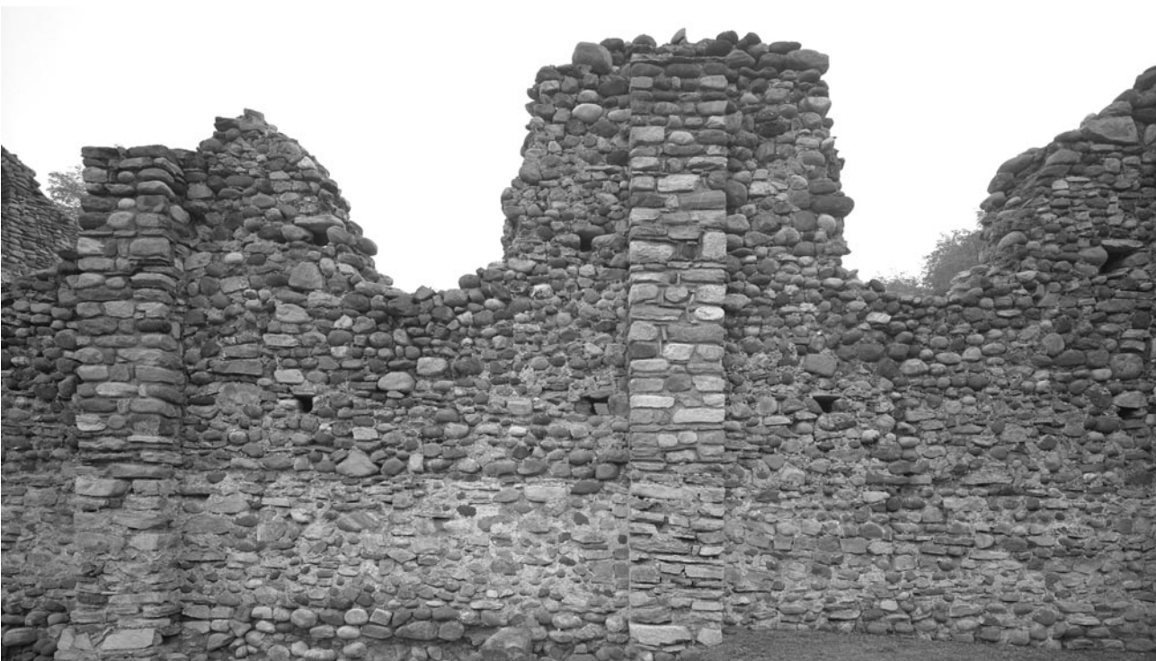
Fig. 17. San Giovanni Evangelista, perimetrale nord esterno. Si noti l'orizzontamento, al di sotto del quale la muratura conserva ancora la malta di legante, erosa nella parte alta probabilmente più esposta alle intemperie dopo il crollo delle murature.
