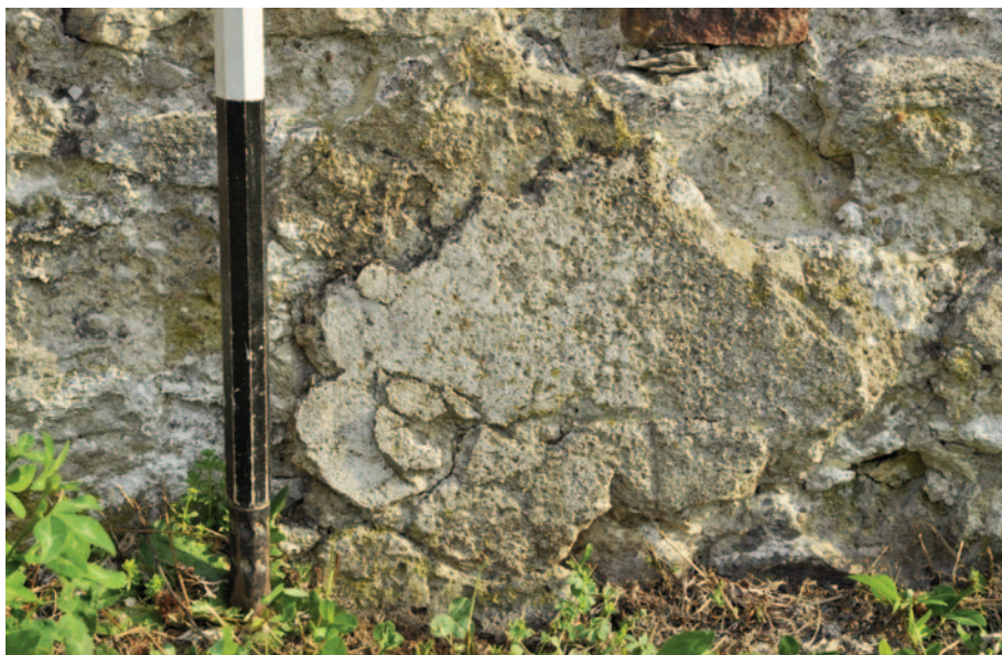
Fig. 18. San Giovanni Evangelista, interno, particolare della sequenza degli intonaci.
